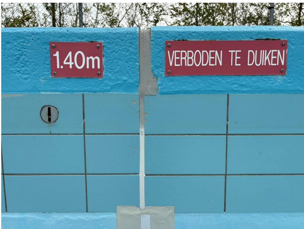
Afbeelding 08 – dilatatievoeg bassin, glazuurgebreken komen in dit wanddeel met name direct naast de dilatatievoeg voor, mogelijk als gevolg van vocht/chloorindringing via openstaande voegen en ongeglazuurde zaagkanten van de keramische tegels.
