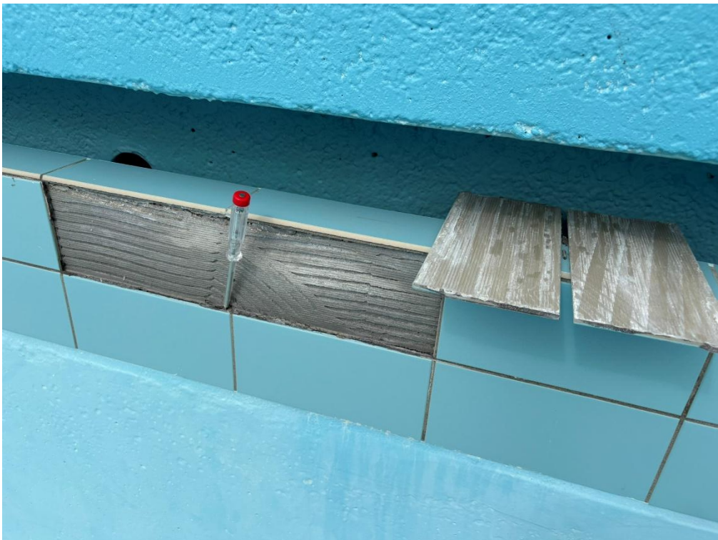
Afbeelding 06 – loszittend tegelwerk, geen hechting tussen tegel en lijmoppervlak. Loszittend tegelwerk komt met name (maar niet uitsluitend) voor ter plaatse van de overloopgoten.
