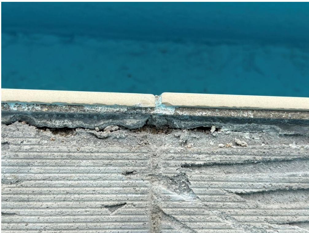
Afbeelding 07 – detail aansluiting verticaal aan horizontaal vlak overloopgoot, mogelijkheid tot vocht/chloor indringing, tevens is te zien dat de zijvlakken van de keramische tegels niet geglaazuurd zijn (het zijn gezaagde, enigszins gebrokkelde tegels)
