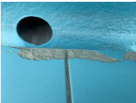
Afbeelding 03 – bovenzijde overloopgoot met glazuurgebreken in diverse stadia
